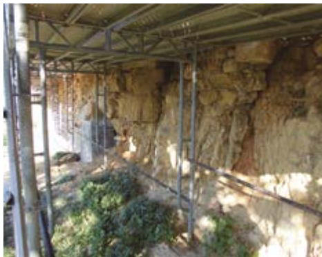
Fig. 46 - Trabajos de recalce del tramo de muralla junto al baluarte de San Antonio. Se observan las margas degradadas bajo la base de la fortificación (2014).
