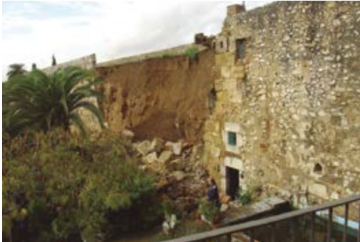
Fig. 37 - Derrumbamiento del tramo de muralla del Huerto del Arzobispo. Año 2005.
