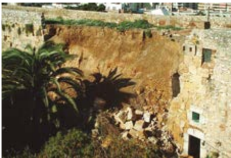
Vista del derrumbe en el tramo del huerto del Palacio del Arzobispo (2005)
