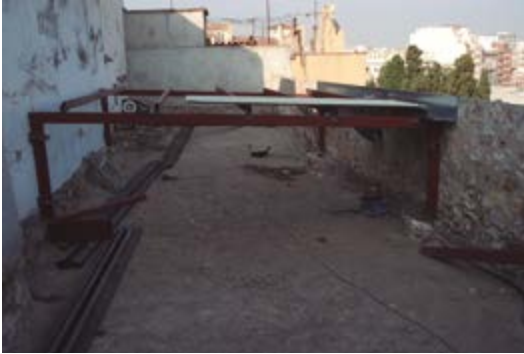
Fig. 38 - Inicio de los trabajos de instalación de cubierta provisional en el adarve del tramo de la Via del Imperio (2007).
